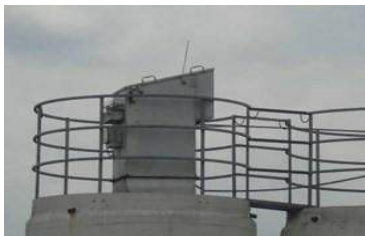
Ontluchtingsfilter op silo (zuigend)
