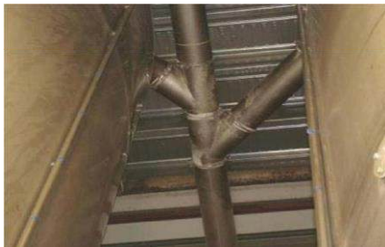
Ontluchtingsleiding naar centraal filter
